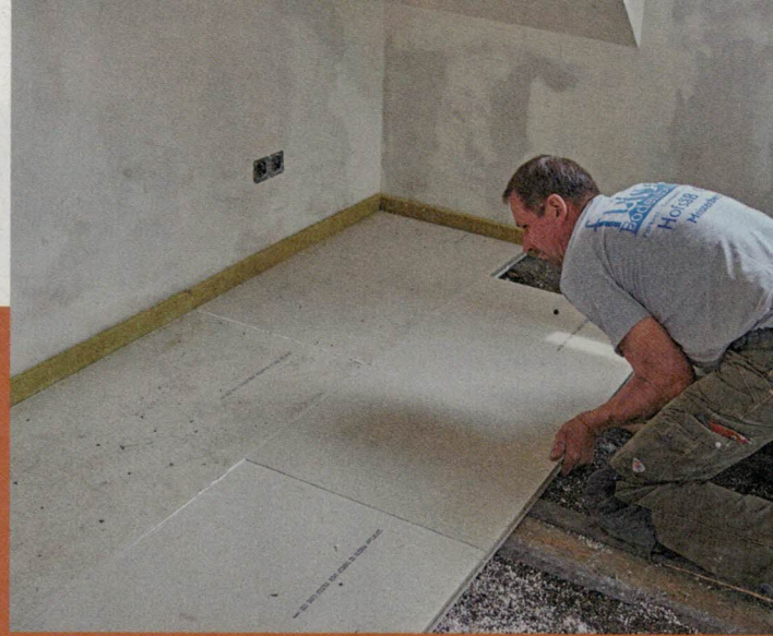
13 ... nächsten Elements. Dann die Platten press stoßen und andrücken. Nur so ist gewährleistet, dass die Plattenkanten versatzfrei durchlaufen für die nächste Reihe. Der Kleber muss oben herausquillen.
