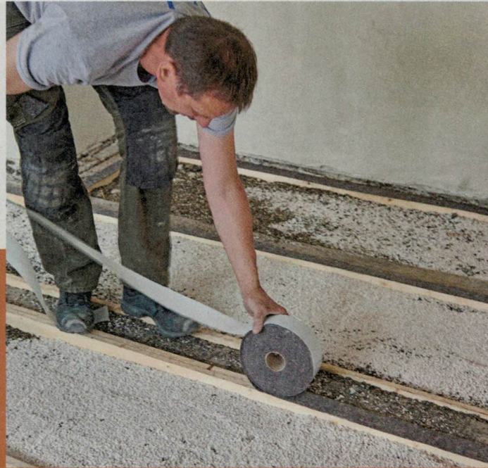
7 Ebenso ganz wichtig: Das Aufbringen eines textilen Trennstreifens auf den Oberkanten der Brettanlaschungen. Denn hierauf verlegt man ja dann die Estrichelemente und die sollen ja schallentkoppelt liegen.
