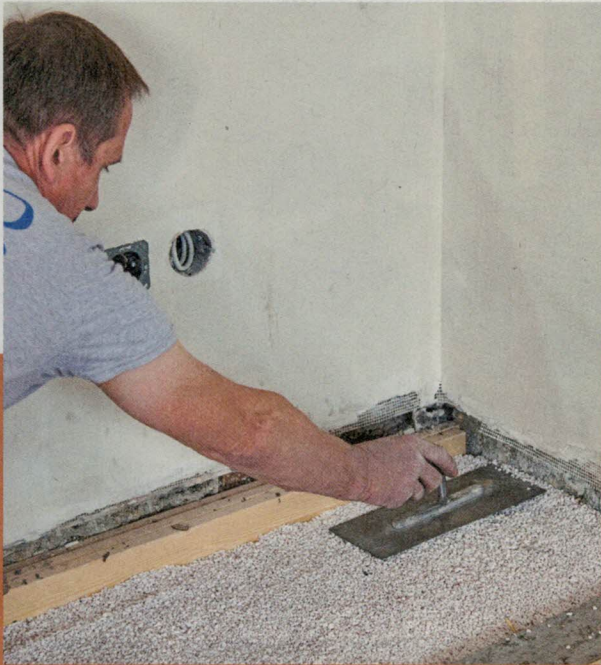
6 Das Material in den Zwischenfeldern wird etwas verdichtet und gleichmäßig abgezogen. Das kann man auch lagenweise machen. Damit lässt sich der Schallschutz noch ein wenig verbessern.
